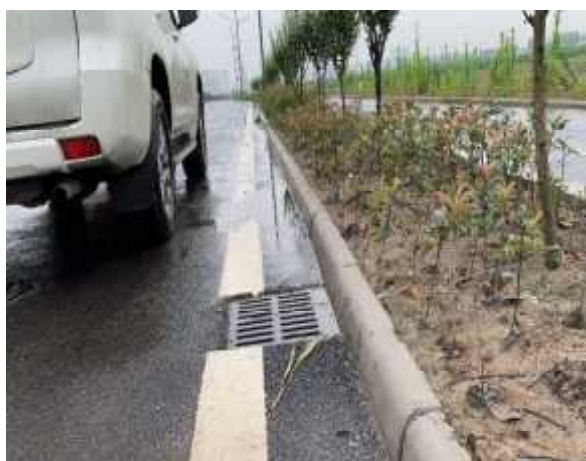
连接线II道路雨水口
