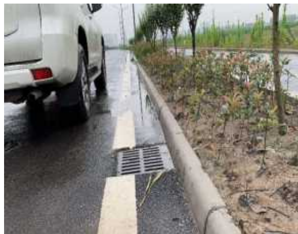
连接线II道路雨水口
