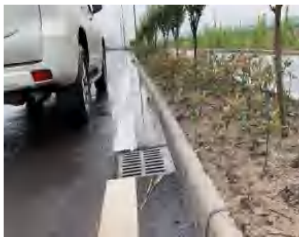
连接线II道路雨水口
